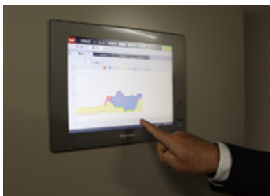
エネルギーマネージメントシステム（Y-EMS）。エネルギー機器の最適制御や見える化、省エネ診断を行う。エネルギー機器に異常が発生したらYESにすぐ知らせる機能も備わっている
