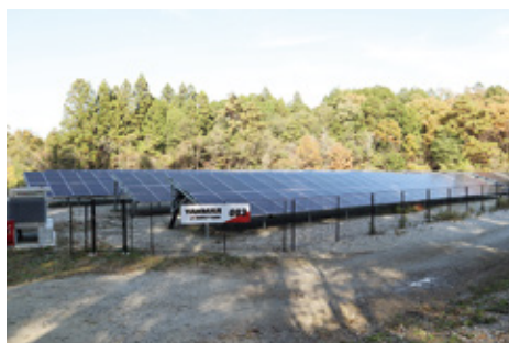
太陽光発電システム「YANMAR ENERGY FARM」。300kWの電力を供給する。晴天ならばクラブハウスの営業中の電力がすべて賄え、光熱費削減にもつながる
