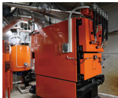
木質チップボイラー。燃料庫のチップを使って稼働する。CO 2 排出量削減に貢献
